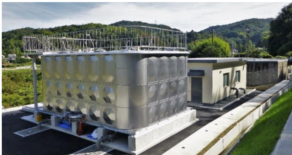
西原加圧ポンプ場（尾原地内）（撮影：令和元年 10 月）
