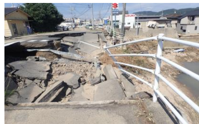
（平成30年7月豪雨 道路損壊状況）
