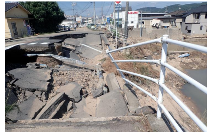
平成30年7月豪雨 道路損壊状況
