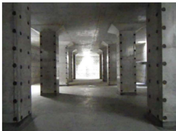
写真 3.4 倉敷駅東雨水貯留施設の内部
