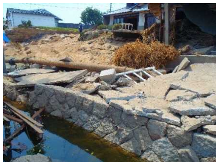
管路施設の破損
