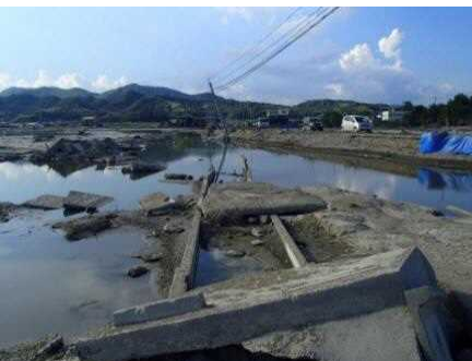
水路損壊・土砂堆積
