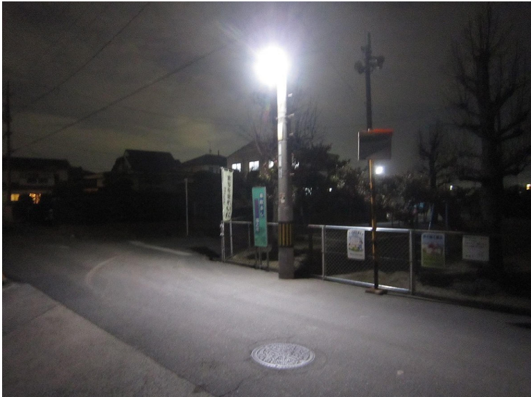
[点灯中照明器具2] 点灯中照明器具の 全景がわかるよう撮影 (完成写真のみ)
