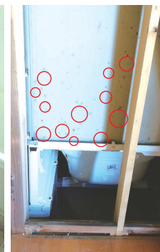
裏側に発生したカビ
