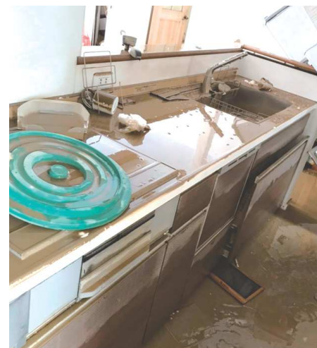
浸水したシステムキッチン
