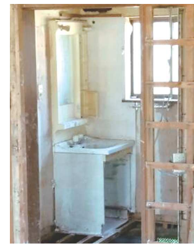
浸水後の洗面台
