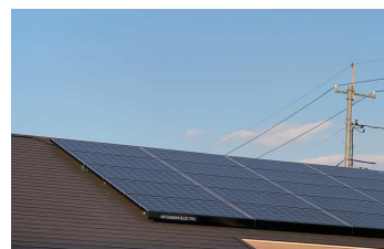
太陽光パネル
