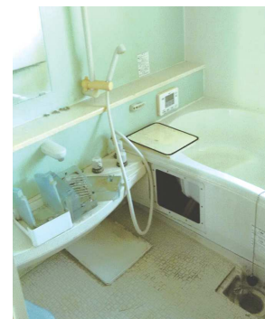
浸水したユニットバス
