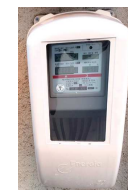
電気メーター
