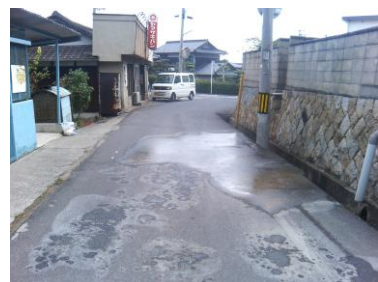
○水道管が破裂
