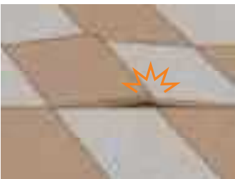
床タイルの浮き
