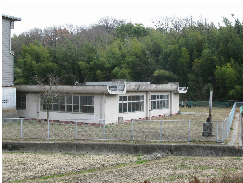
建物の老朽化が顕著で廃墟の印象
