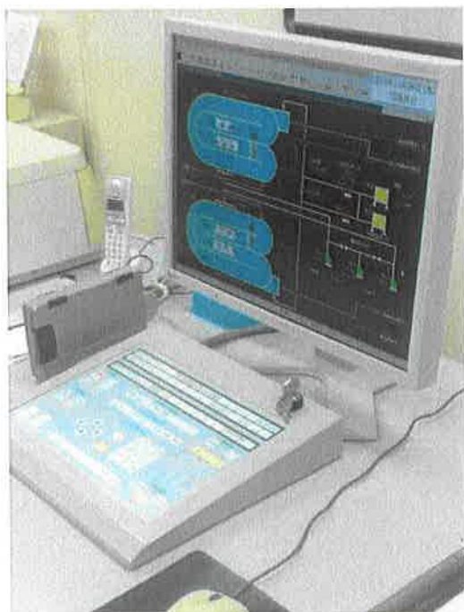
真備浄化センター
