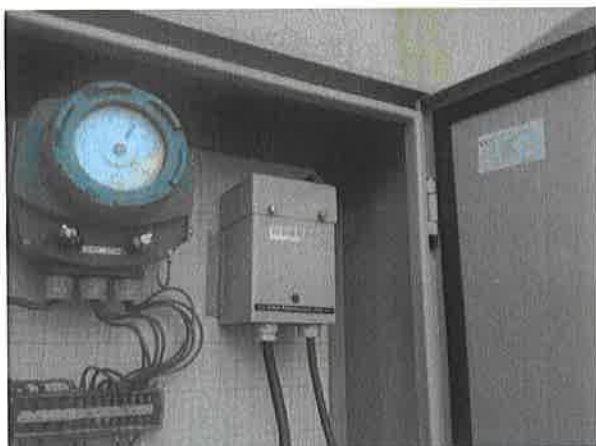
PH測定器（水島下水処理場）
