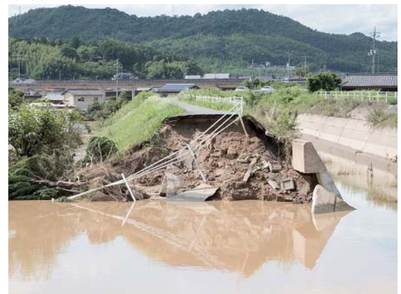
탁류로 인해 붕괴된 제방 제방이 붕괴되면 눈 깜짝할 사이에 가옥의 침수가 시작됩니다. 붕괴 지점 부근에서는 토사의 유입이나 가옥의 파괴가...
