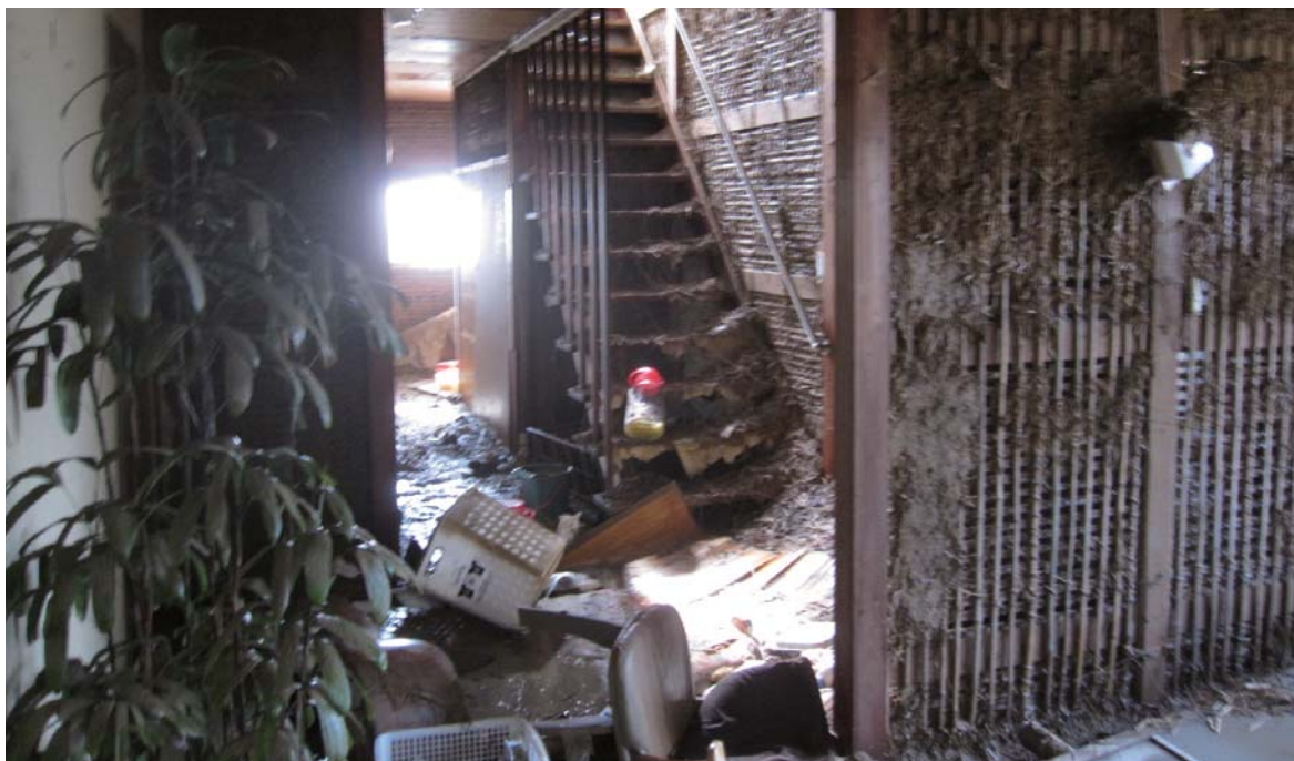
Tình trạng bên trong ngôi nhà bị thiệt hại
