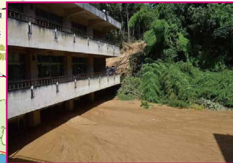
平成 23 年 9 月 郷内小学校 台風第 12 号による土砂災害
